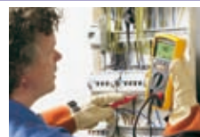
Проверка изоляции в распределительном щите
